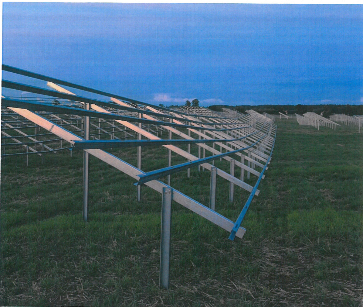
Ryc. nr 8 Konstrukcje wsporcze posadowione w gruncie bez fundamentowania cechują się małym oddziaływaniem na glebę.
