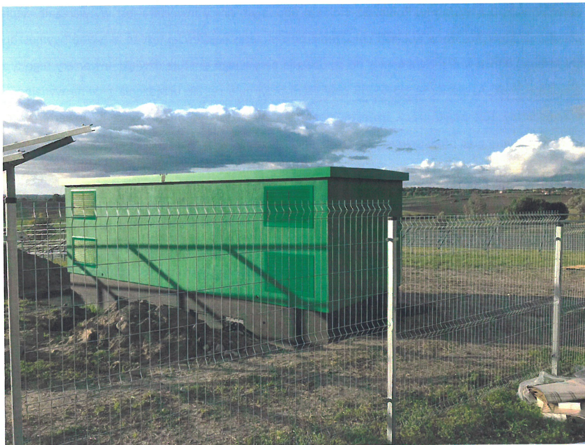
Ryc. nr 10 Przykładowa stacja transformatorowa
