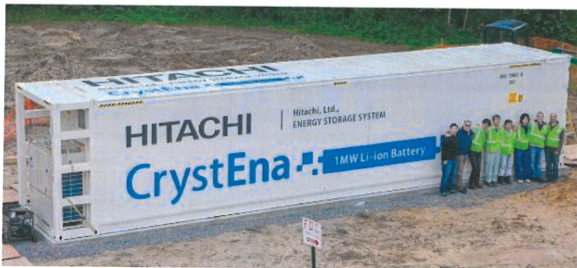
Ryc. nr 11 Przykładowy kontenerowy magazyn energii o pojemności 1 MW, Hitachi „CrystEna”. Inwestor planuje zastosowanie wtapiających się kolorów kontenera.
