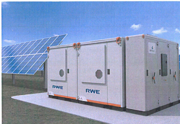
Rys. 3.4. Przykładowy magazyn energii
