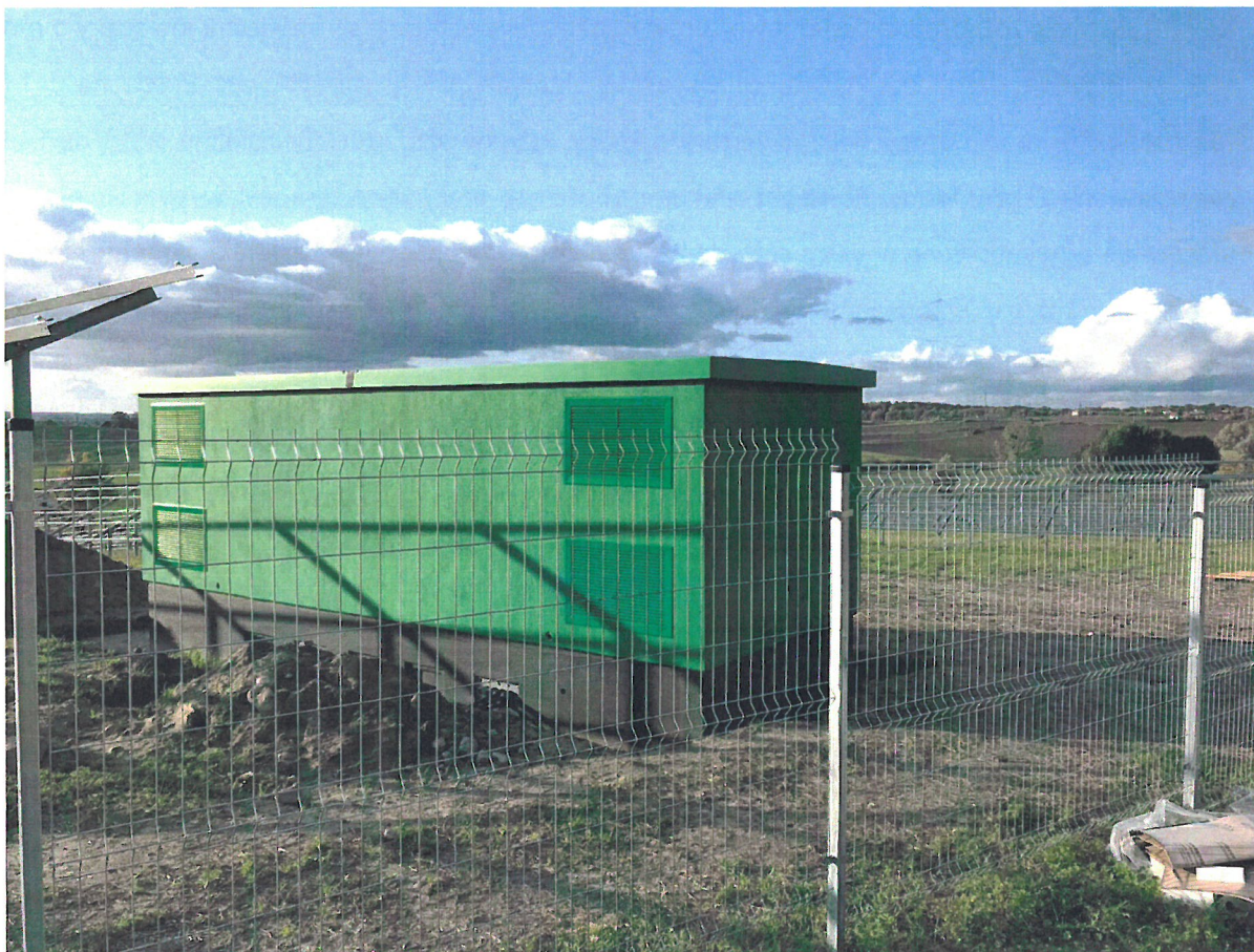
Ryc. nr 10 Przykładowa stacja transformatorowa
