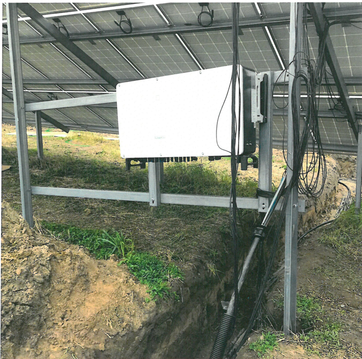
Ryc. nr 10 Przykładowy inwerter mocowany do konstrukcji wsporczej
