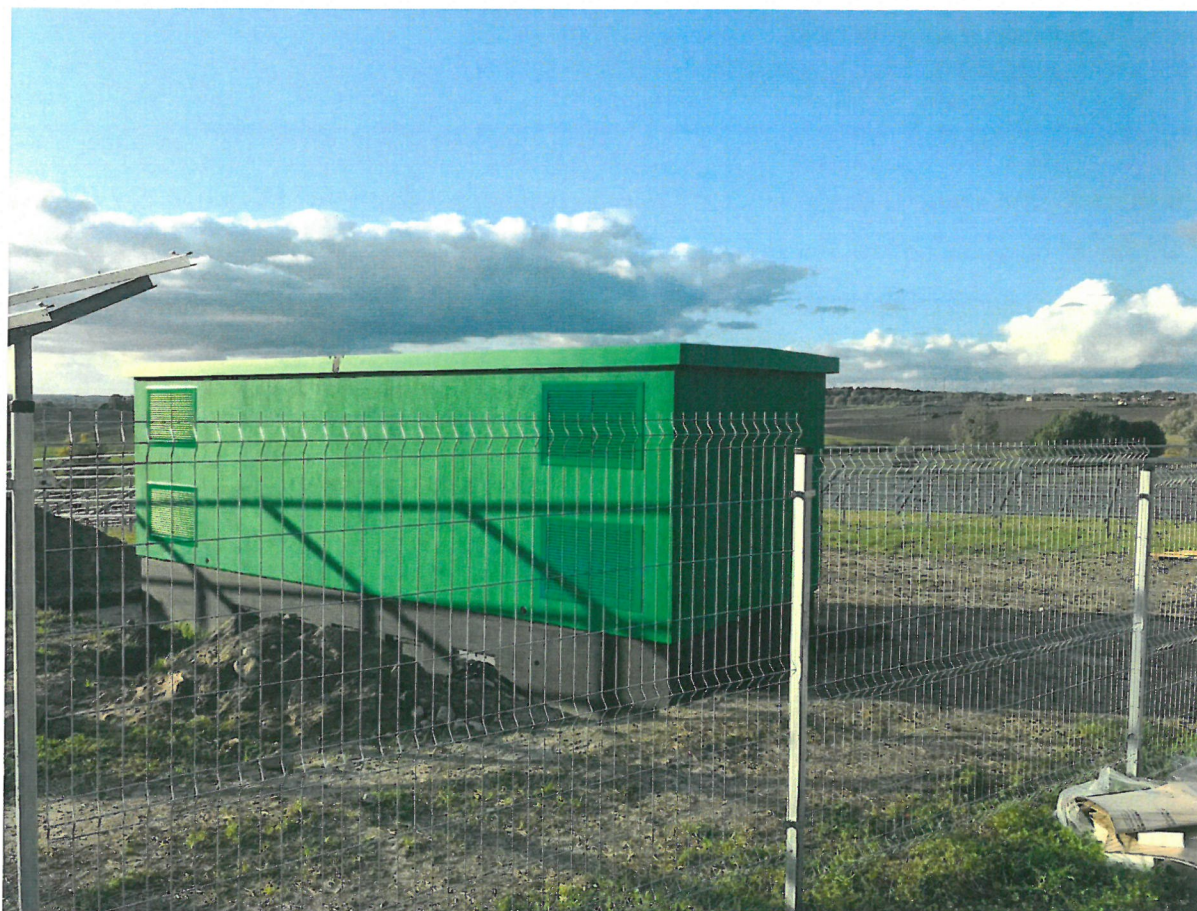
Ryc. nr 11 Przykładowa stacja transformatorowa
