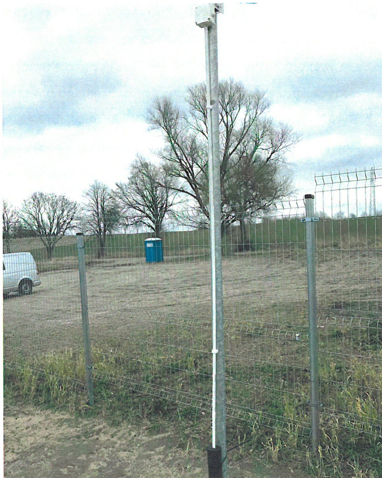
Ryc. nr 13 Ogrodzenie farmy fotowoltaicznej uniesione nad gruntem i przykładowy maszt do oświetlenia
