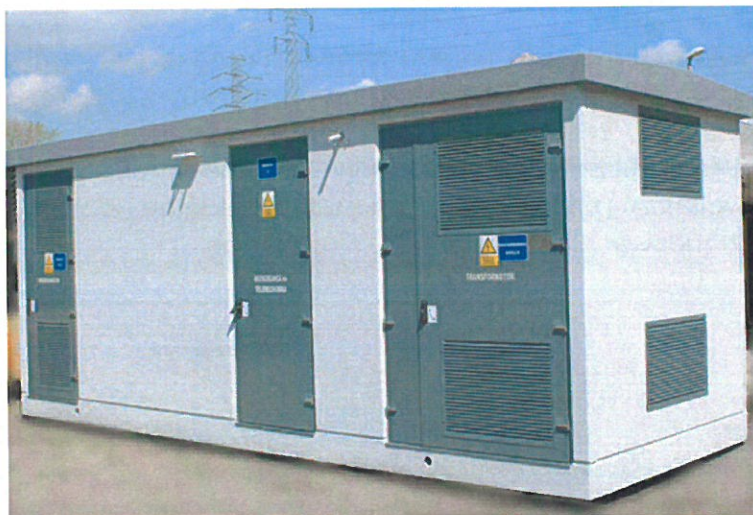
Rys. 3.3. Przykładowa stacja transformatorowa
