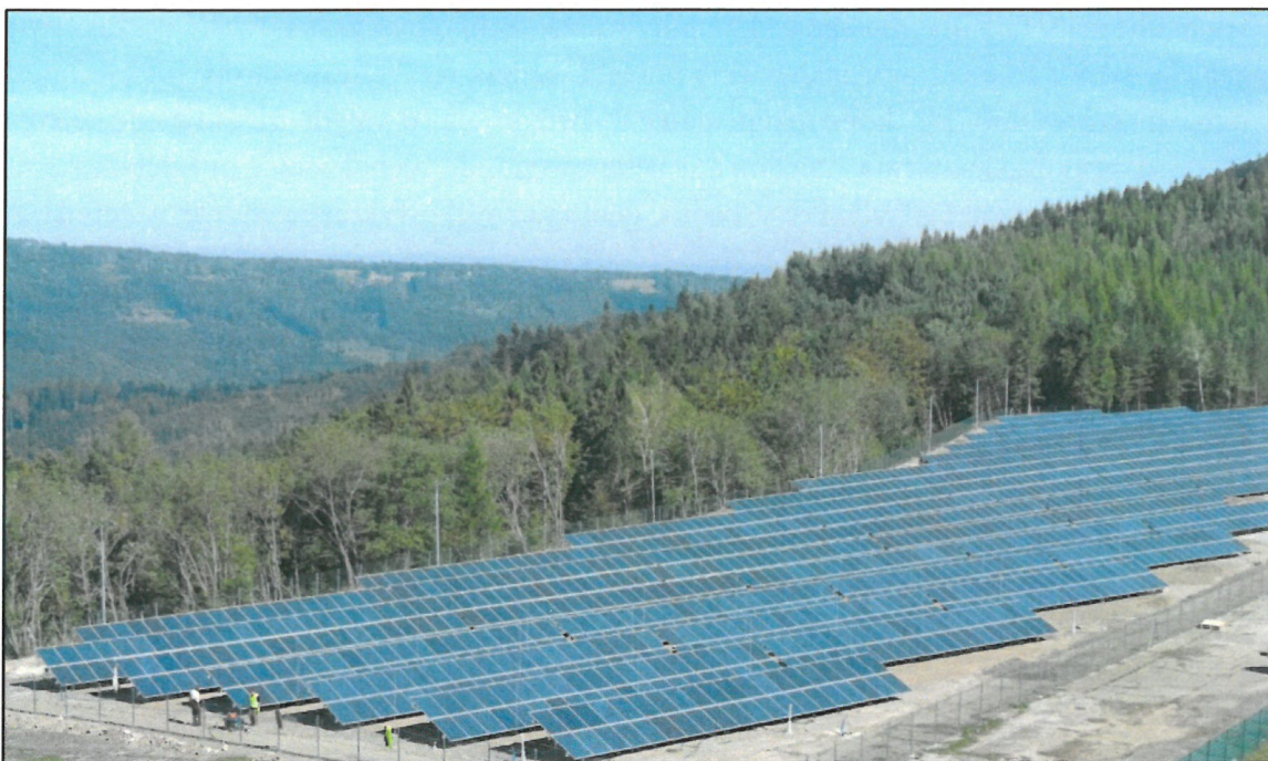
Fotografia. 1. Zrealizowana przez PGE Energia Odnawialna S.A. farma fotowoltaiczna na górze Żar.
