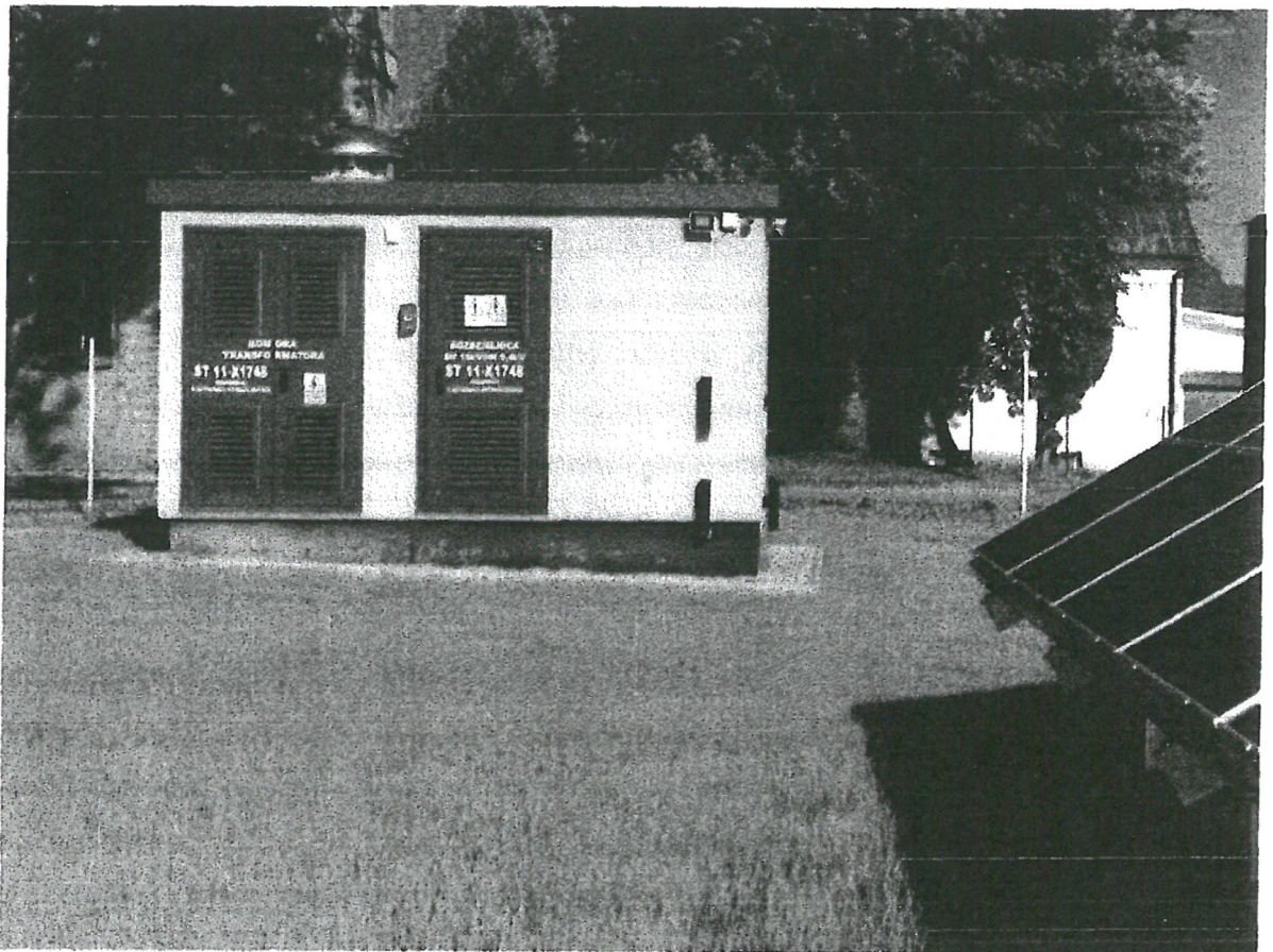
Zdj.2. Przykład kontenerowej stacji transformatorowej, w której umieszczony jest transformator (na podst. gosolar.pl)
