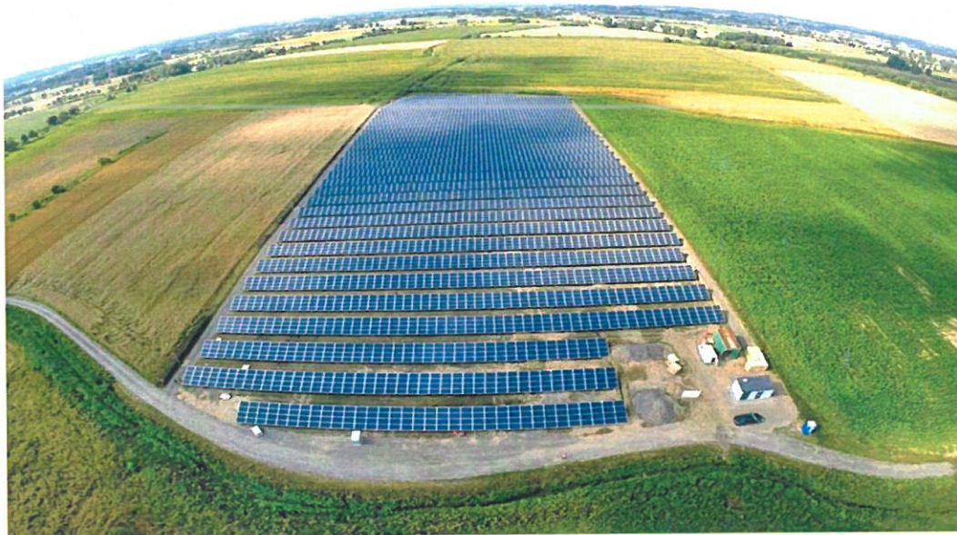
Rysunek 6. Elektrownia fotowoltaiczna pod Gubinem
