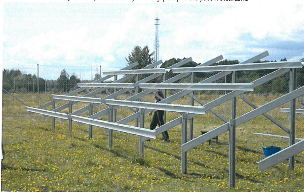
Rysunek 4. Konstrukcja – stoły pod panele fotowoltaiczne
