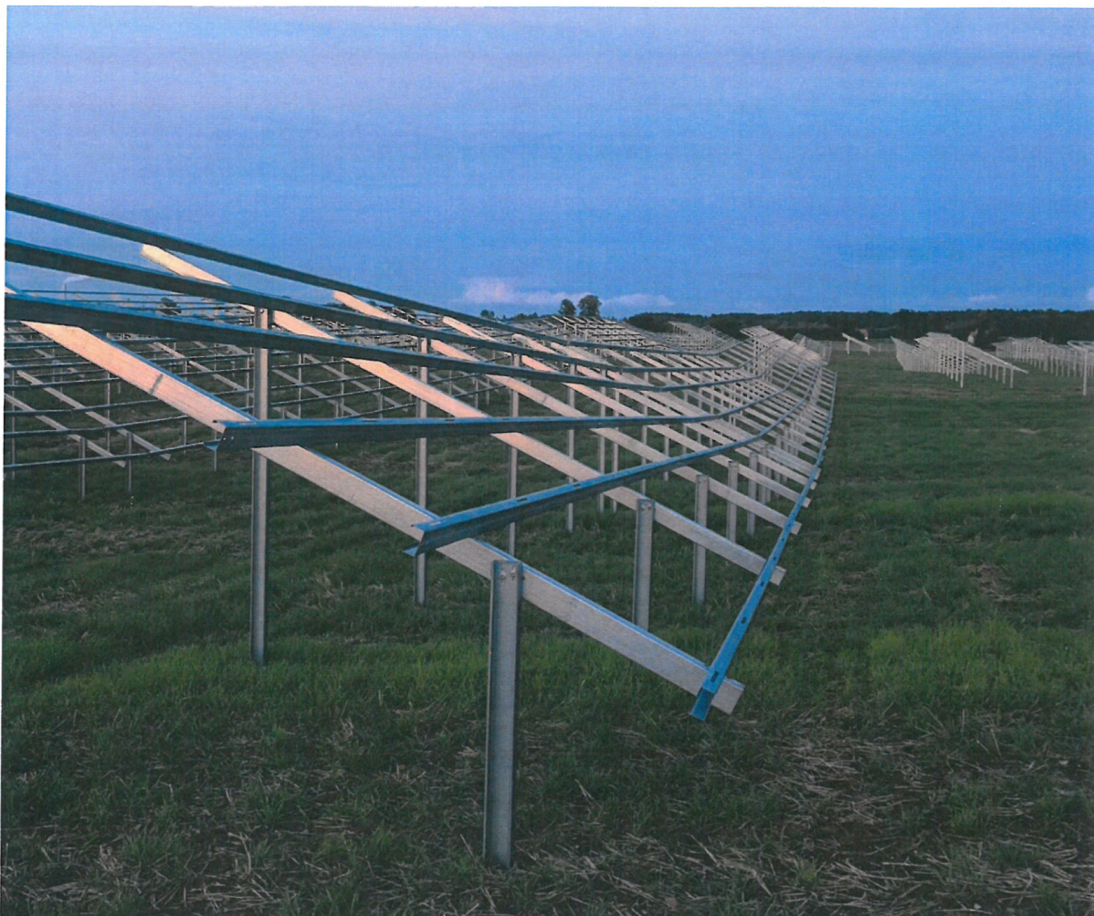
Ryc. nr 8 Konstrukcje wsporcze posadowione w gruncie bez fundamentowania cechują się małym oddziaływaniem na glebę.
