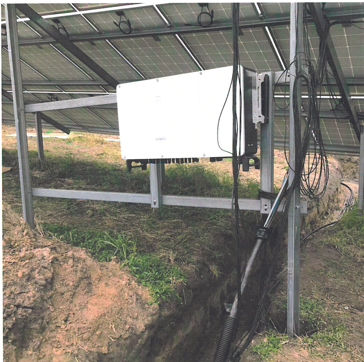
Ryc. nr 9 Przykładowy inwerter mocowany do konstrukcji wsporczej
