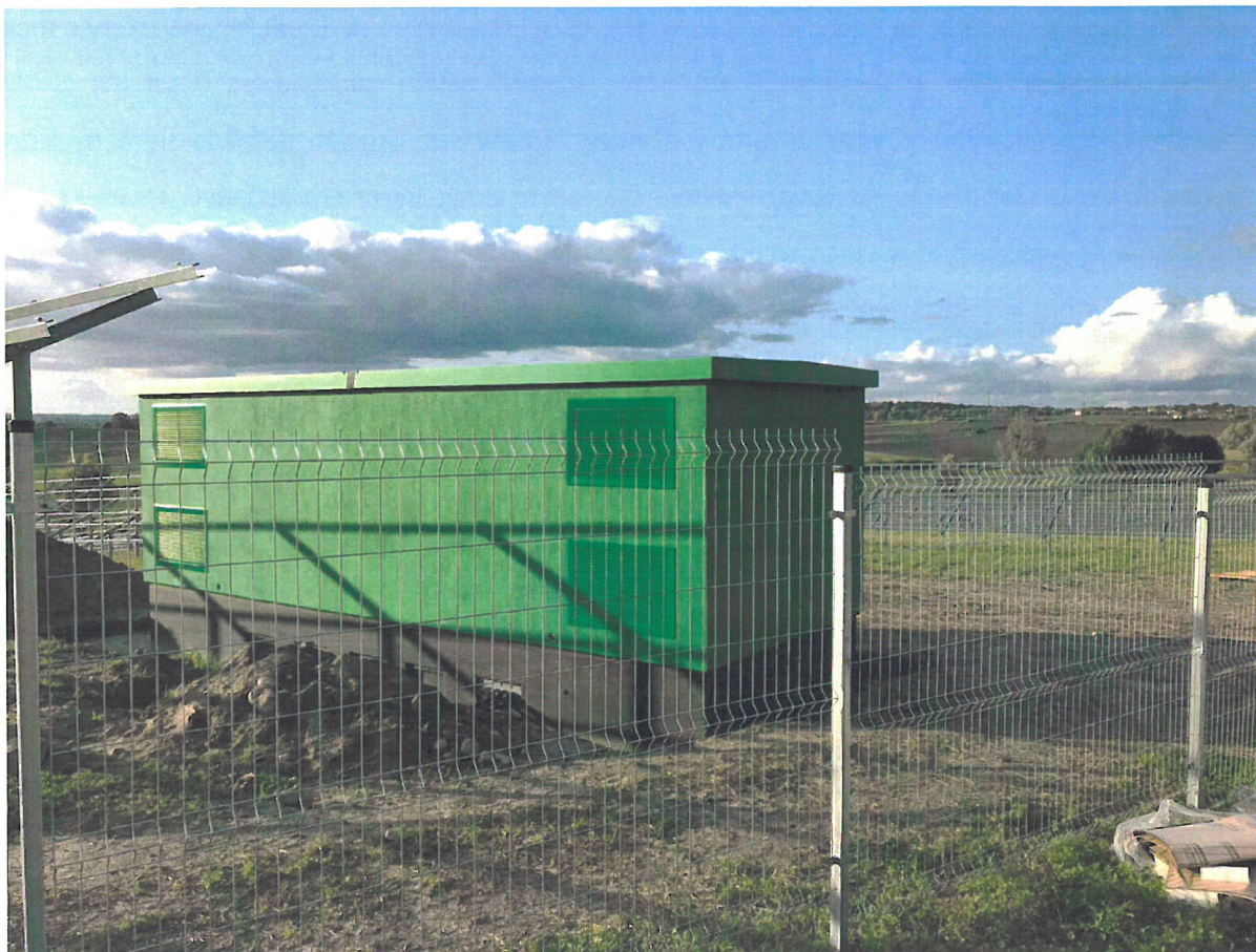
Ryc. nr 10 Przykładowa stacja transformatorowa
